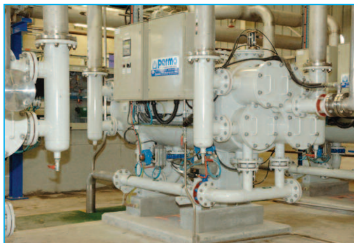
L'un des 4 filtres autonettoyants de l'installation
