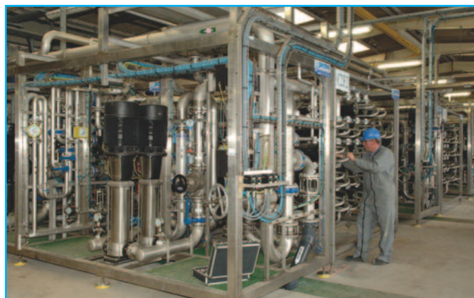
Vue des modules de pré traitement d'eau et de leurs pompes 15 bar
