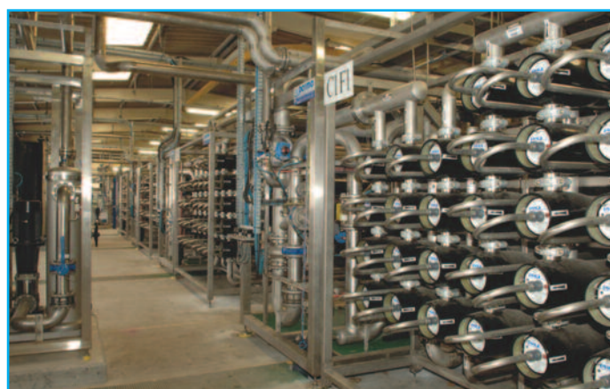
Vue des batteries d'osmoseurs. L'installation compte 124 corps de pression répartis en 4 lignes d'osmose.
