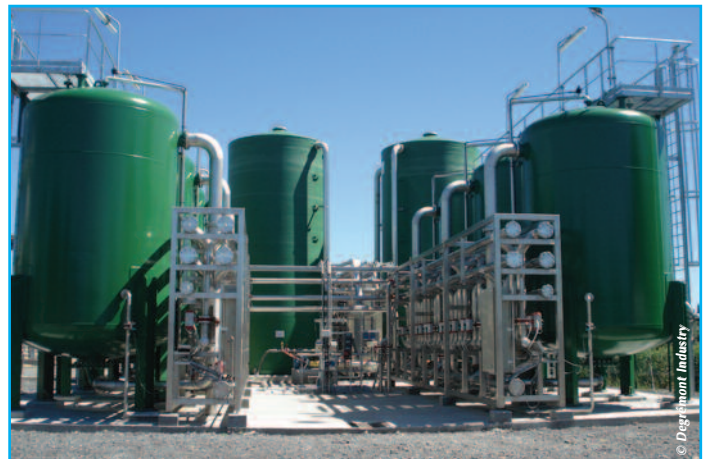
Unité de traitement des AOX sur le site de Dow à Chauny
