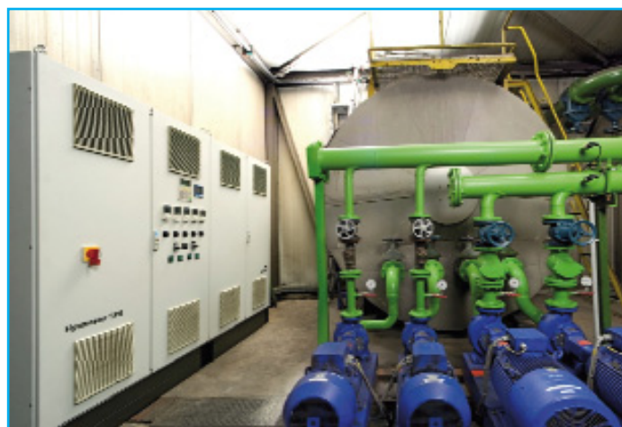
La mise en place de variateurs de vitesse peut engendrer jusqu'à 60 % d'économie d'énergie selon les spécialistes de KSB.
