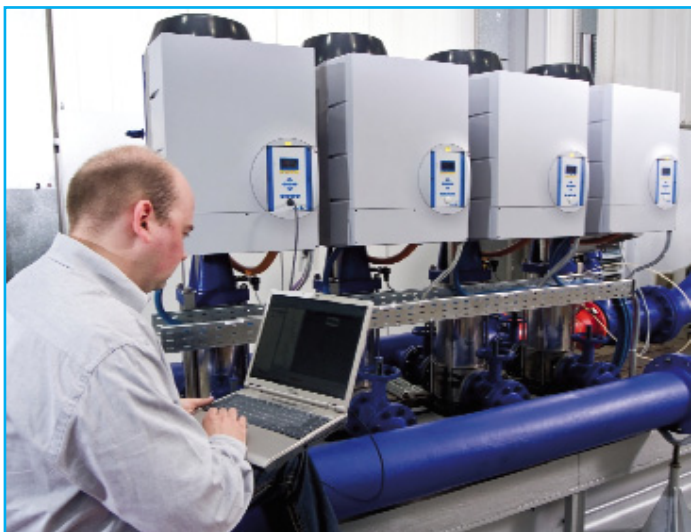
L'installation et le paramétrage de variateurs de vitesse demande beaucoup de soin.
