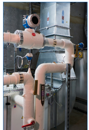
La mesure est au cœur des économies d'énergie. Ici mesures de débit et de température sur de l'eau glacée. Un préalable à des prestations complètes de mesure de performance énergétique.
