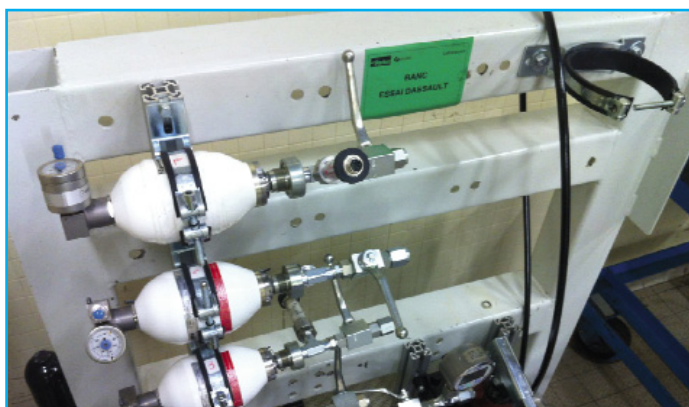
Des racks de stockage d'azote à haute pression
