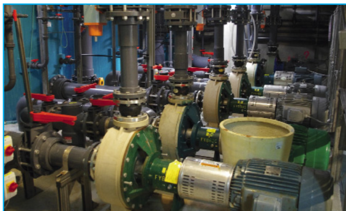
La salle de pompage
