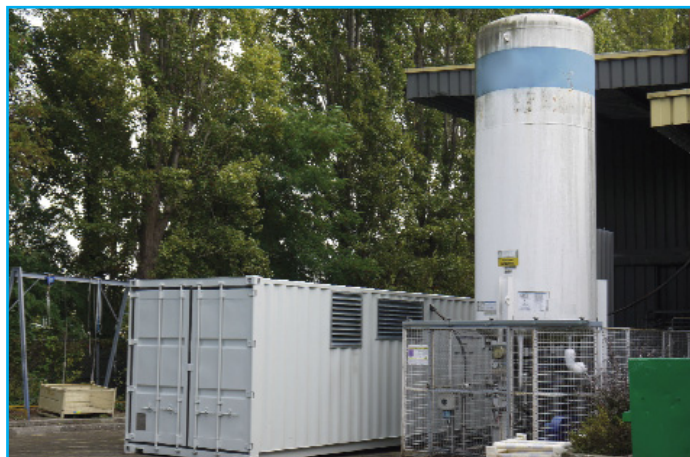
Le container contient tous les équipements de production d'azote
