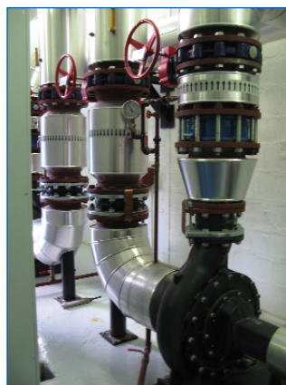
L'ensemble des réseaux de chaleur ont été modernisés à l'occasion de la mise en place de la chaufferie bois
