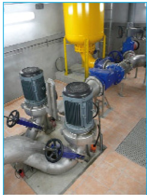
Station de pompage en ligne DIP « gros débit » à 3 pompes
