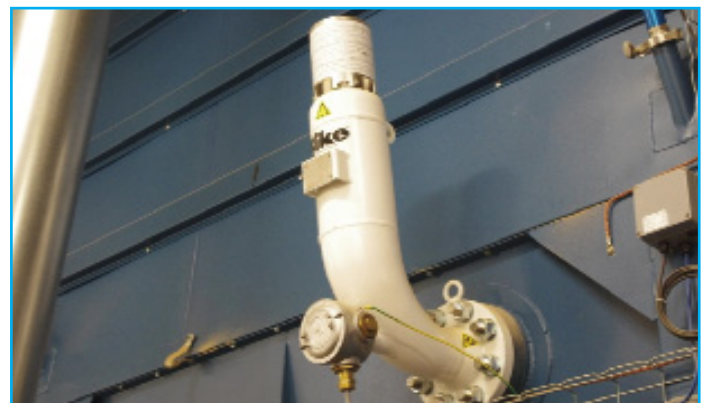
Photo 6 (système de suppression et d'isolement d'explosion FIKE)
