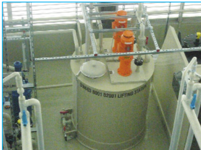
Installation de régénération d'acide
