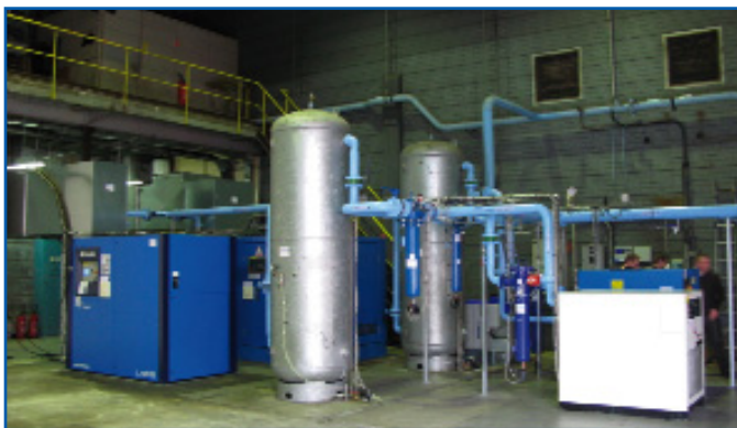
La nouvelle centrale d'air comprimé
