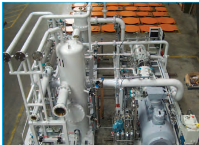
Skid prêt au départ en usine
