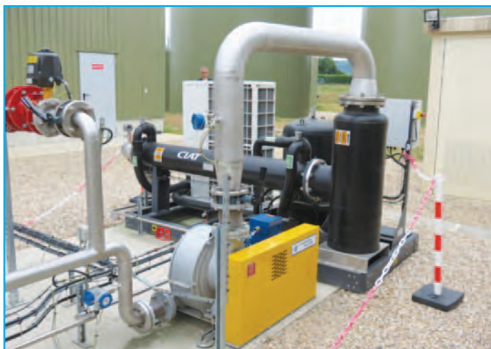
Le poste de surpression du gaz
