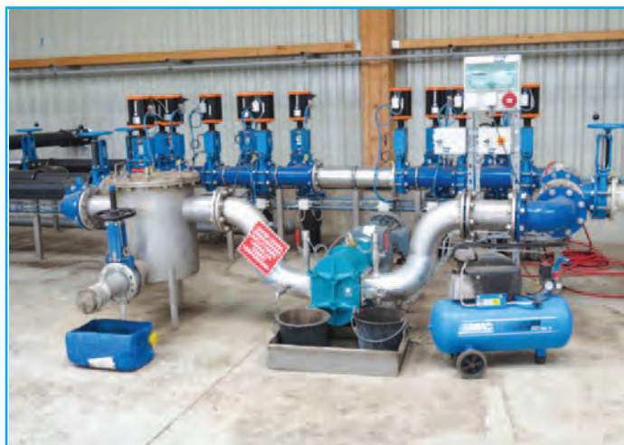
L'une des stations de pompage de l'unité de Gaillon
