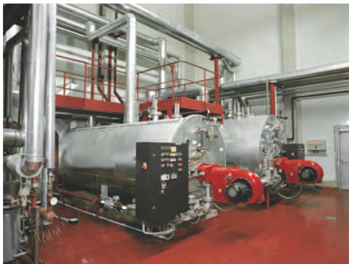
Le fonctionnement des chaudières vapeur est au programme du stage 770
