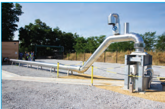
La station de pompage prélève l'eau à raison de 900 à 1 000 m 3 /heure
