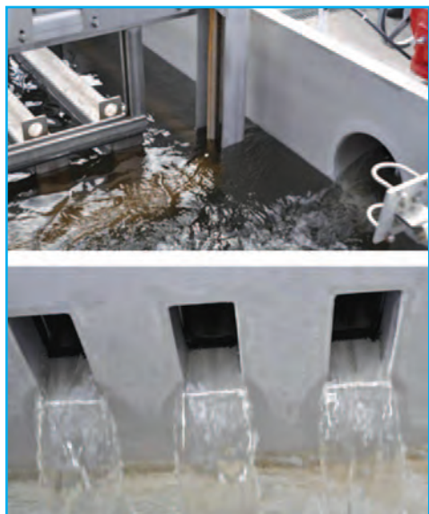
Le bioréacteur à membrane MBR et la filtration Iso-Disc AS-H permettent de réutiliser les eaux traitées comme eaux de process ou de nettoyage
