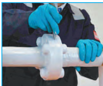
Photo 4. Système encapsulé pelé pour inspection
