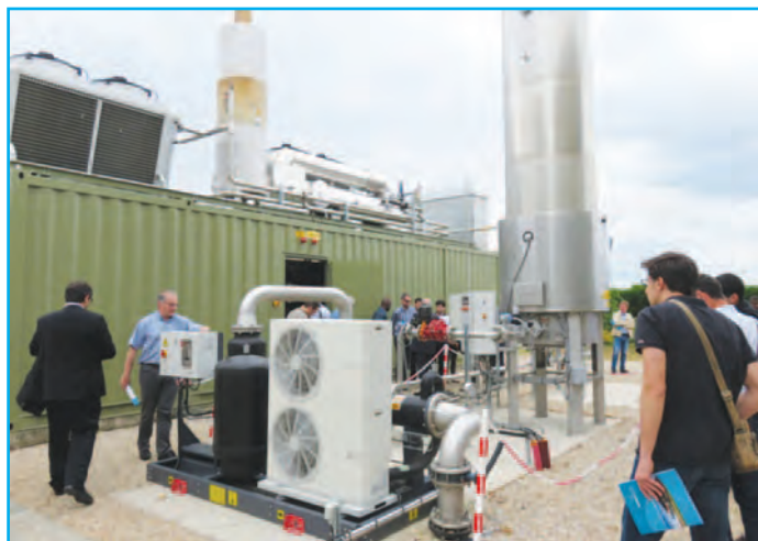
Vue générale du local de cogénération et de son environnement
