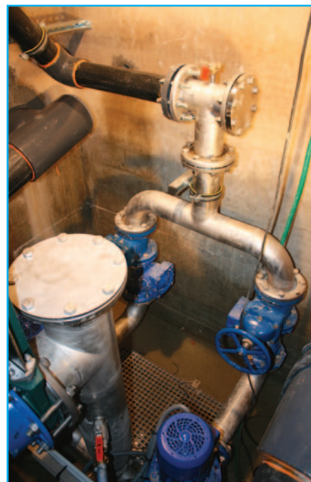
La station de relevage en ligne SRL a été choisie afin de répondre à la nécessaire discrétion de ce type d'équipement au sein d'un tel bâtiment
