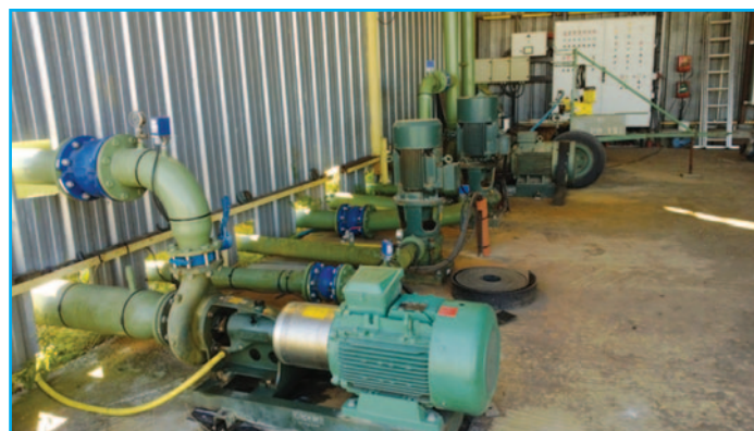
Les installations de pompage agricole et d'irrigation sont parfois très importantes et, à l'image du monde industriel, sont de plus en plus techniques.
