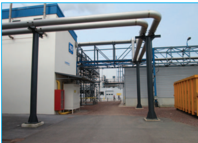
Le bâtiment abritant les nouveaux équipements a été judicieusement placé près de la chaufferie. L'objectif est de réutiliser la chaleur issue de la vapeur d'eau générée par les compresseurs.
