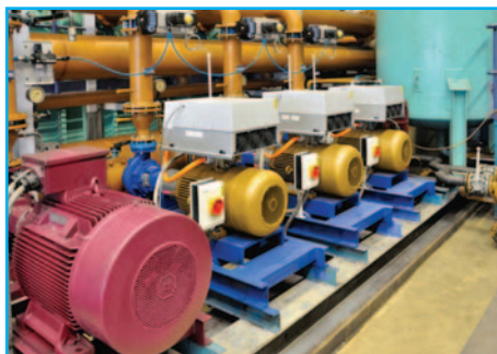
Quatre moteurs Su-PremE à haute efficacité énergétique ont été installés
