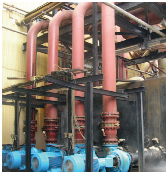
Les formations Eureka permettent régulièrement d'y réaliser des milliers d'euros d'économie d'énergie, de casses prématurées,...
