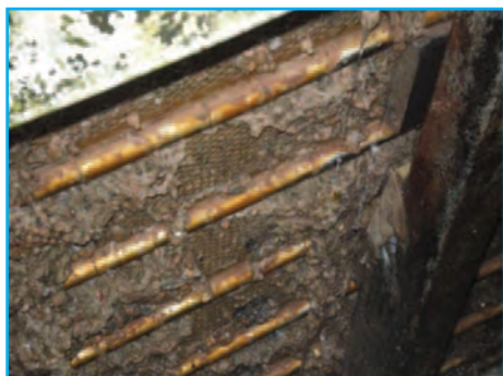
On peut observer le bouchage du tamis du dégrilleur fin avant l'installation des broyeurs.
