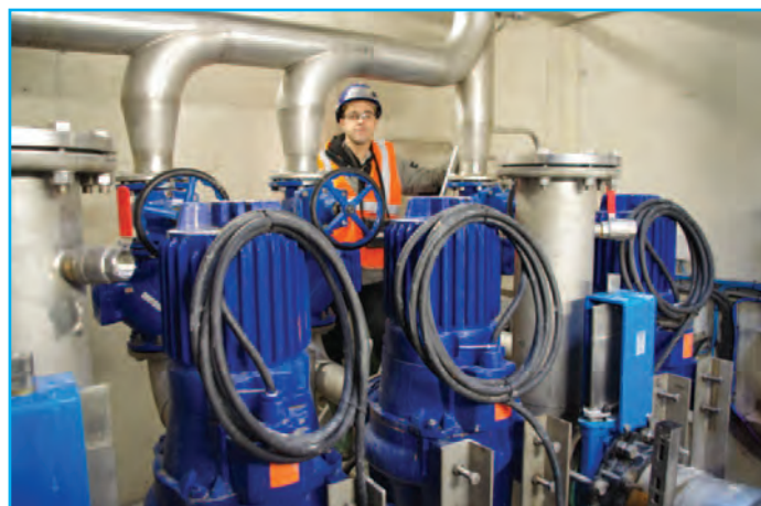
Un responsable de chez SOGEA nous fait visiter la station de pompage
