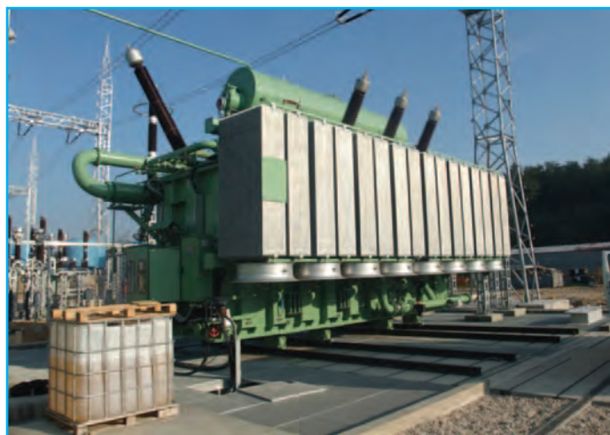
Transformateur équipé du « TP » de Sergi
