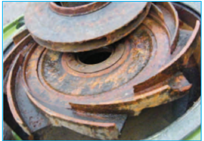
Pompe avant application
