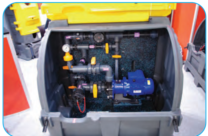
Stockage et Systèmes était également présent avec ses systèmes de dosage et de dépotage de produits chimiques sécurisés
