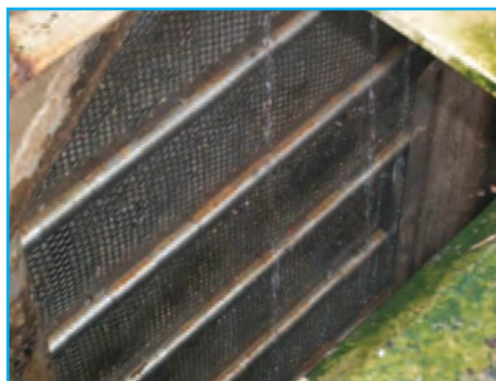
Dégrilleur fin après la mise en route des broyeurs en amont. Le résultat est convaincant.
