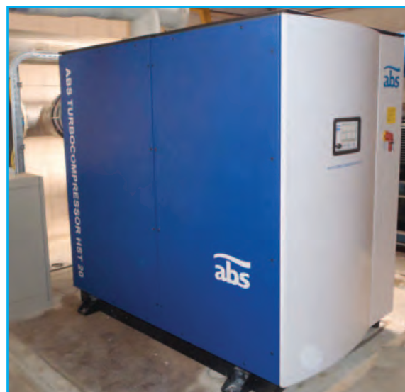
Le turbocompresseur HST installé à la STEP de Laon
