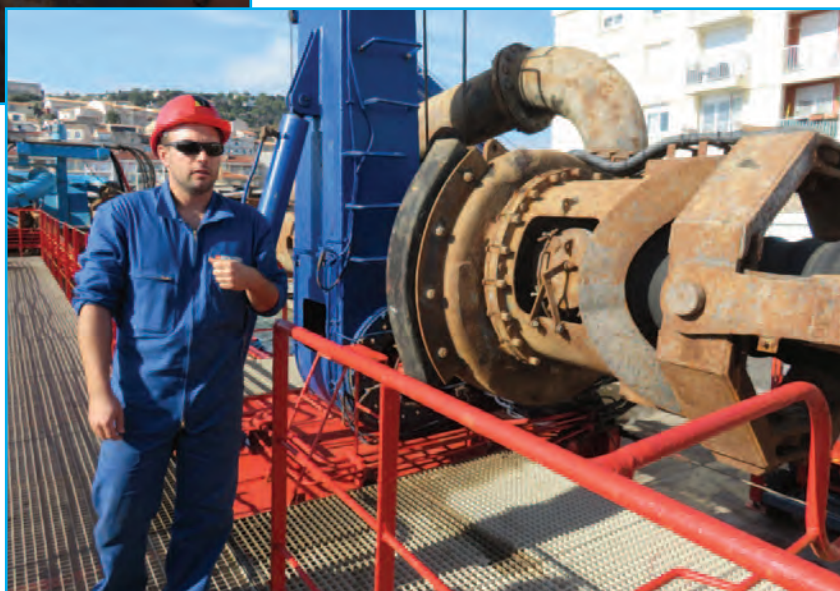
A droite, la pompe de dragage.
