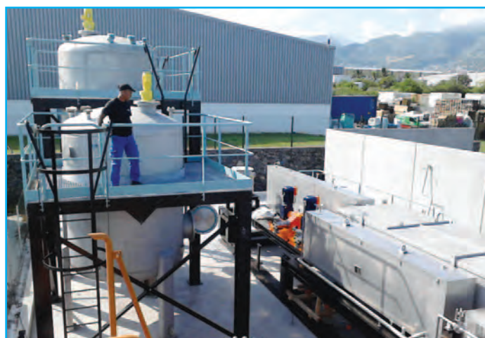
Vue générale d'une installation sur l'île de la Réunion
