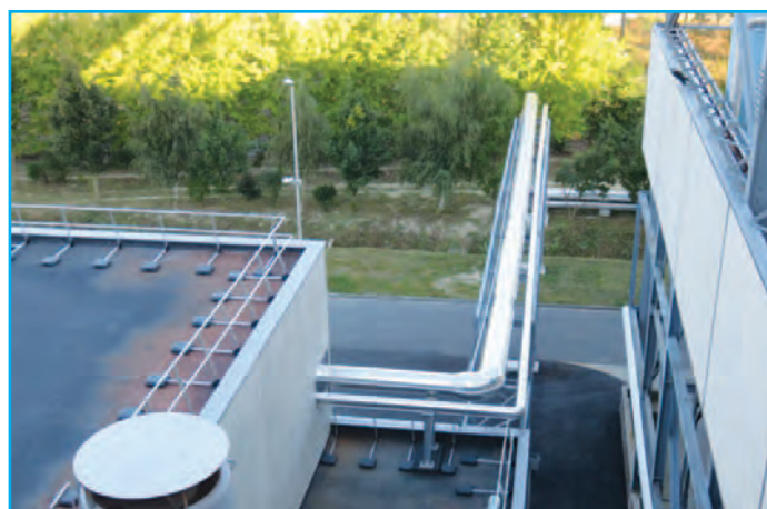
Côté ECOSTU'AIR : le départ de la boucle vapeur vu du haut de l'unité d'incinération
