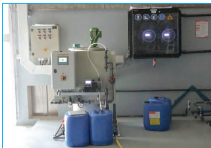
L'ensemble des pompes de la station a été fourni par Grundfos. Ici une installation de dosage
