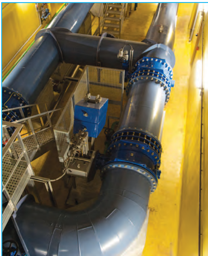
La station de pompage de Montreuil fonctionne à un débit moyen journalier de 46 000 m 3 par jour.
