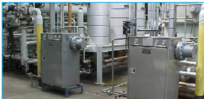
2 Thermojet installés aux abords d'une ligne process.
