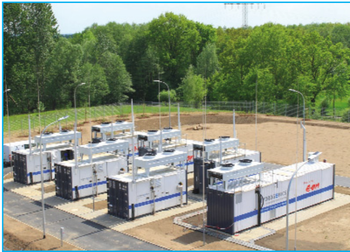
Vue générale de l'installation EON en Allemagne.
