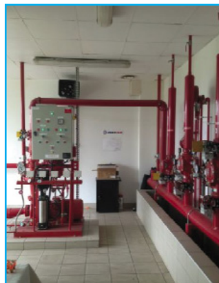
Charité bien ordonnée commence par soi-même : UXELLO a elle-même conçu, réalisé et installé sa salle d'essais de sprinklers, unité de pompage comprise.
