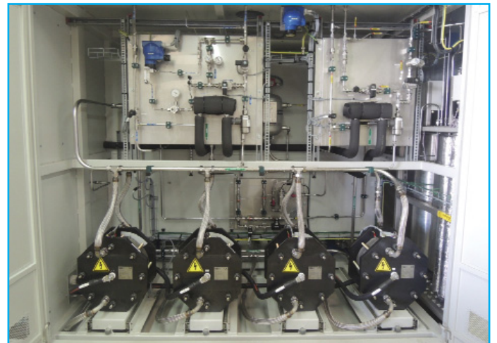
Détail d'une unité d'électrolyse
